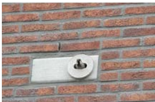
in gevel geïntegreerde nestgelegenheid voor huismussen
