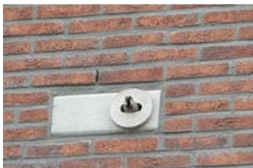
in gevel geïntegreerde nestgelegenheid voor huismussen
