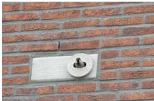
in gevel geïntegreerde nestgelegenheid voor huismussen
